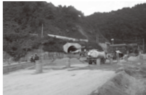
▶トンネルの開削工事が進められているタンコットの峠の麓左上を進むと峠で、勾配がきつく慢性的な渋滞を引き起こしている
